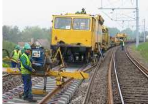
Longs rails soudés sur traverses béton
